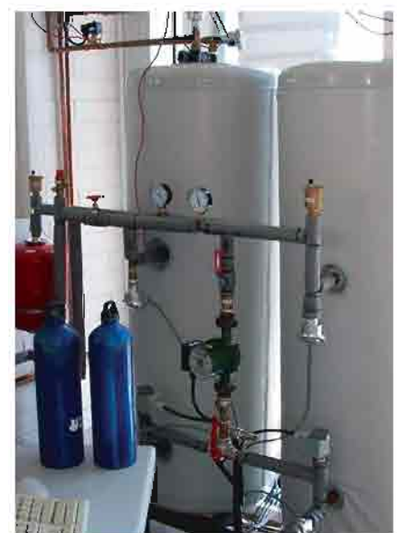
Instal·lació interior (amb dipòsits de Lapesa, SA)
